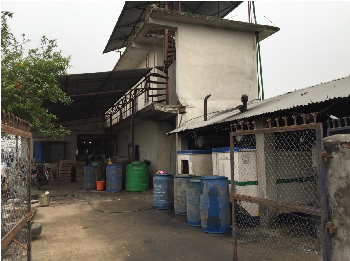
Je 80 Kilowatt-Leistung haben die beiden Diesel-Generatoren der Hühnerfarm, die eine kontinuierliche Stromversorgung sicherstellen
