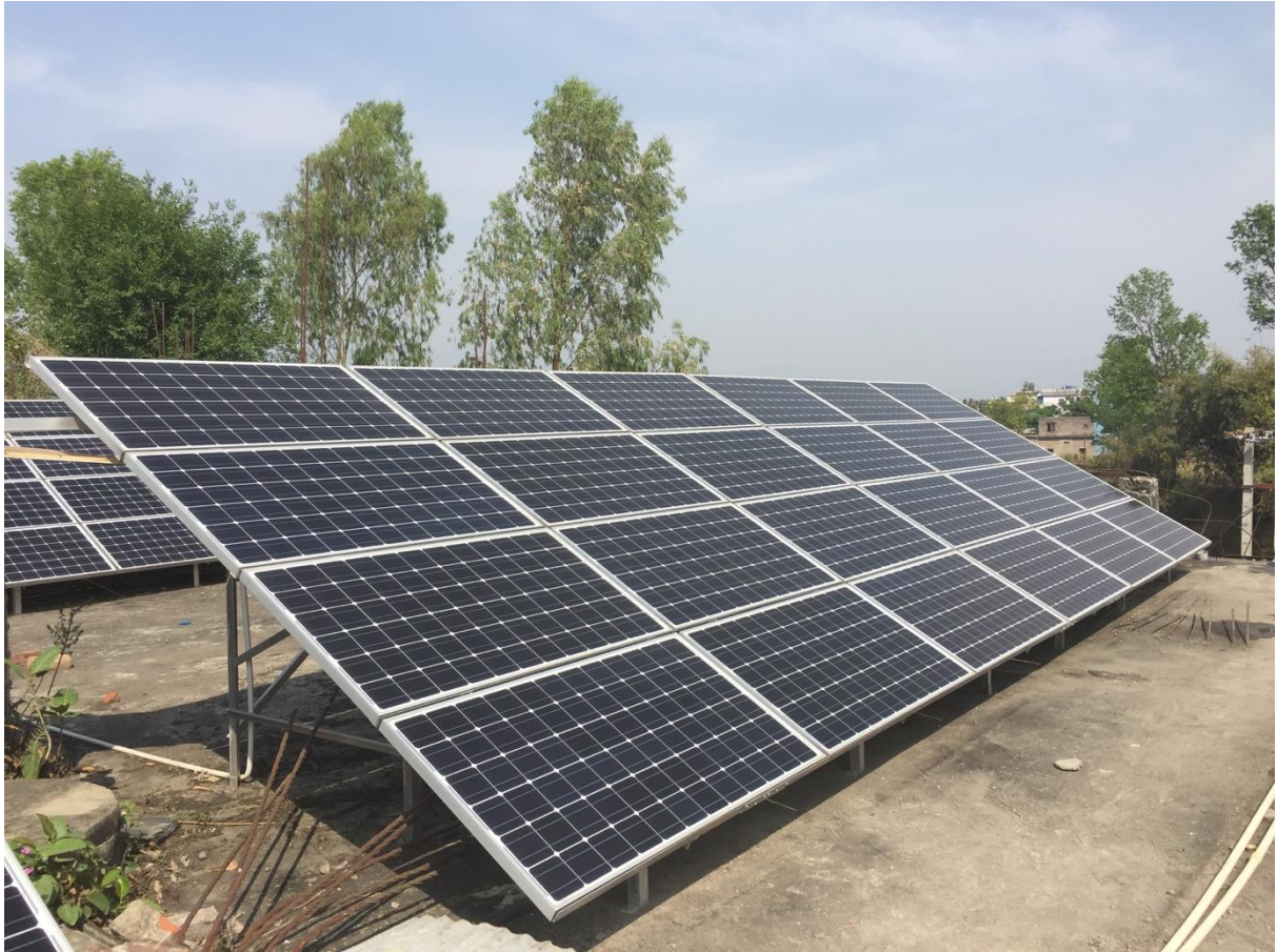
Einundzwanzig Kilowatt Solarmodule sorgen im Ratnanagar-Spital für eine nachhaltige und zuverlässige Energieversorgung
