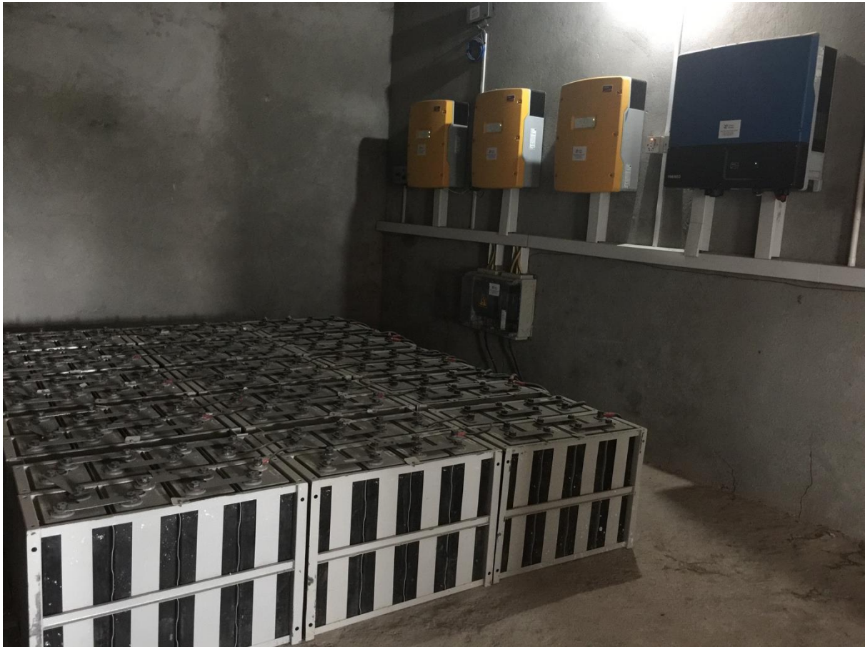
Rund 144 Kilowattstunden Batteriespeicher in Form von 120 Speicherblöcken ermöglichen einen 24-Stundenbetrieb
